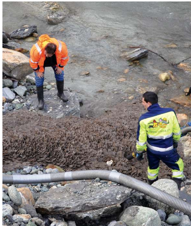
Figure 38 | Ci-dessus | Operation de récupération de biomédias après une fuite importante à la STEP d'Evolène, Suisse, © Commune Evolène
